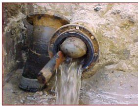
Застрявшую губку можно удалить только с разгерметизацией трубопровода.
